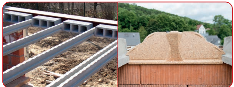
De tussenafstand van de balkjes bepalen door het plaatsen van een vulsteen, een eindstuk of een thermische onderbreker op de uiteinden hiervan.
